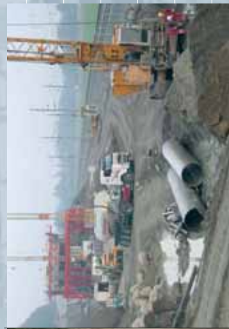
Abb. 5: Errichtung von 15 Großbohrpfählen für die Fundierung der nordseitigen Wand der Grünbrücke Terfens (im Hintergrund der Fundamentschwalgen für die Bodenplatte und der Tragwerkschwalwen für die aufgehenden Wände und Decke).
